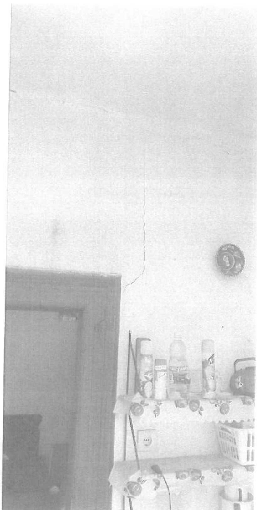
Falazat süllyedés miatti repedések nyoma a konyhában
