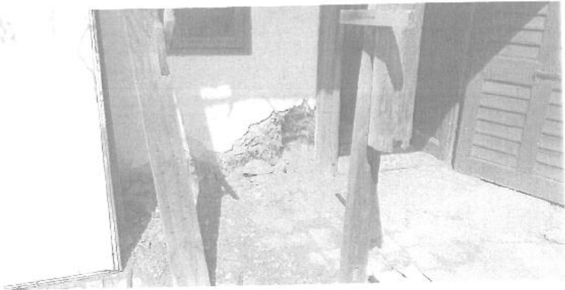
Főfal alapozás nem megfelelősége miatti felázás nyoma déli homlokzat
